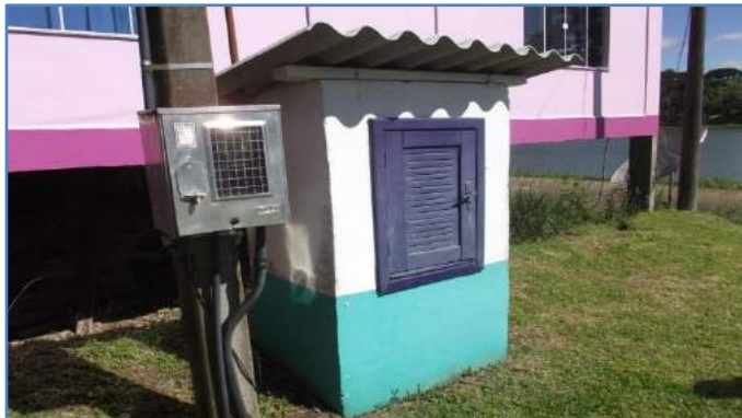
Imagem 15: Casa de quadro de comando.
