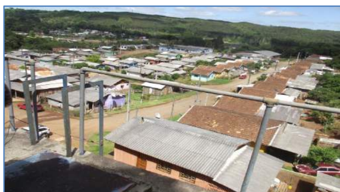
Imagem 53: Proteção lateral na cobertura.
