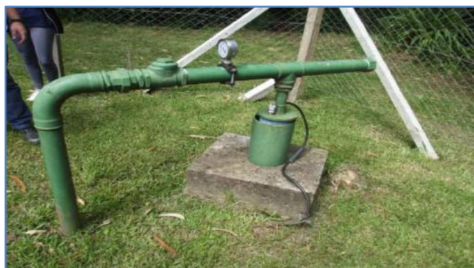
Imagem 26: Instalações hidráulicas do poço.
