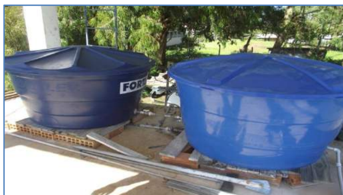
Imagem 36: Tina de preparo de cloro e flúor.
