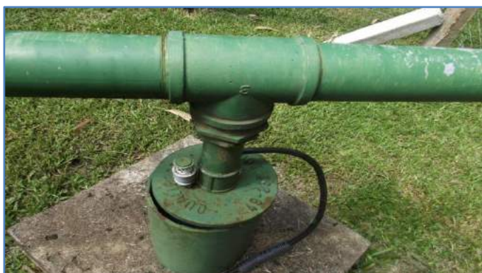
Imagem 27: Medidor de nível e instalação elétrica.
