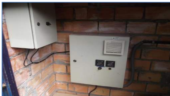
Imagem 24: Quadro de comando.
