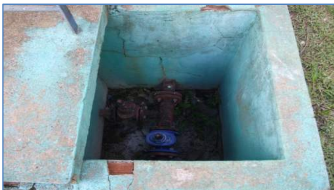
Imagem 61: Caixa de registro de manobra.
