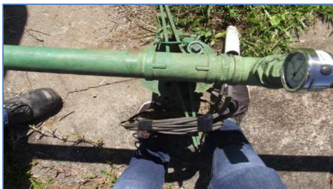
Imagem 6: Instalações hidráulicas do poço.
