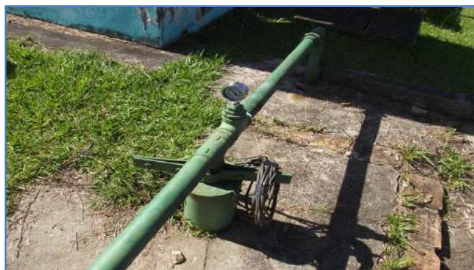
Imagem 7: Medidor de pressão na saída do poço.
