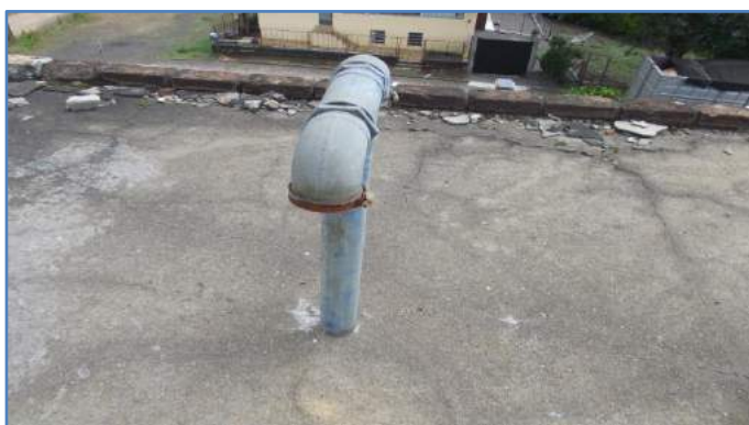
Imagem 63: Duto de ventilação.
