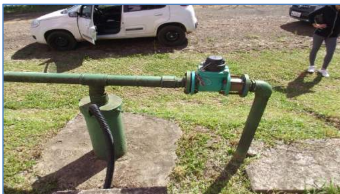
Imagem 11: Instalações hidráulicas do poço.
