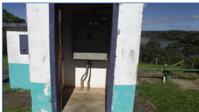
Imagem 4: Quadro de comando.
