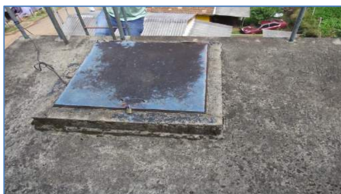
Imagem 54: Tapa de inspeção.
