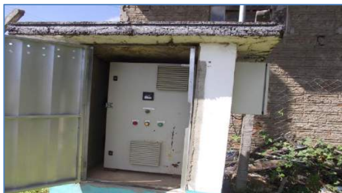
Imagem 22: Quadro de comando.
