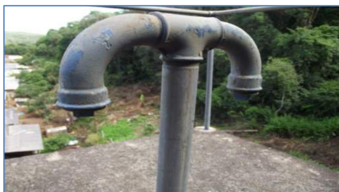
Imagem 55: Duto de ventilação.
