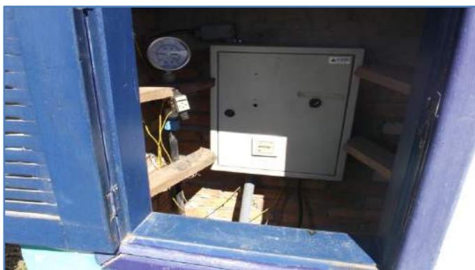
Imagem 16: Quadro de comando e medidor de pressão.
