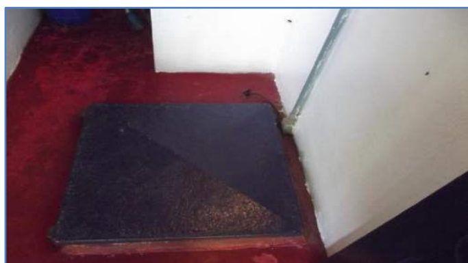
Imagem 31: Tampa de inspeção da câmara de contato.
